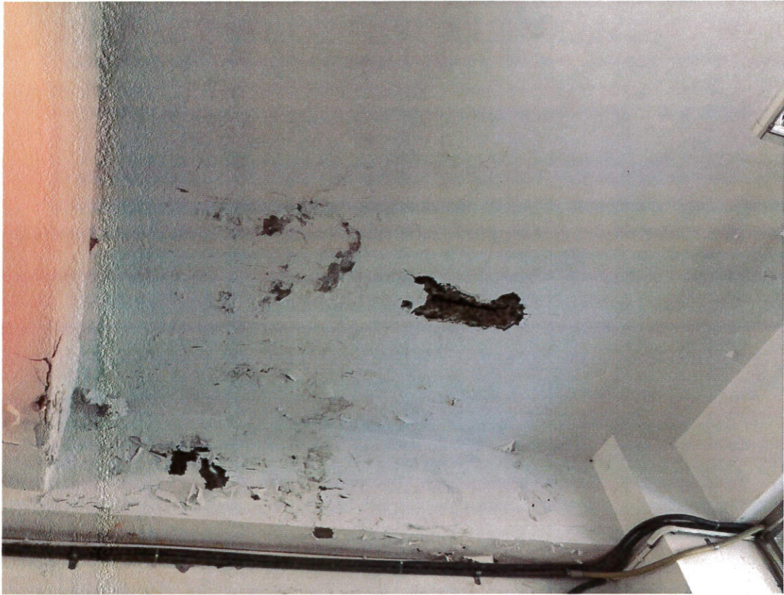
仁愛樓 609 教室，鋼筋裸露，已請廠商估價修繕。
