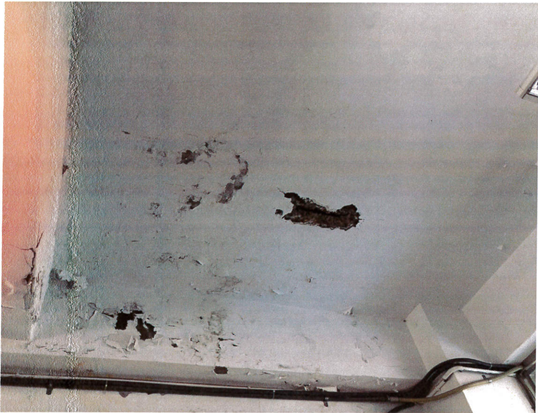
仁愛樓 609 教室，鋼筋裸露，已請廠商估價修繕。
