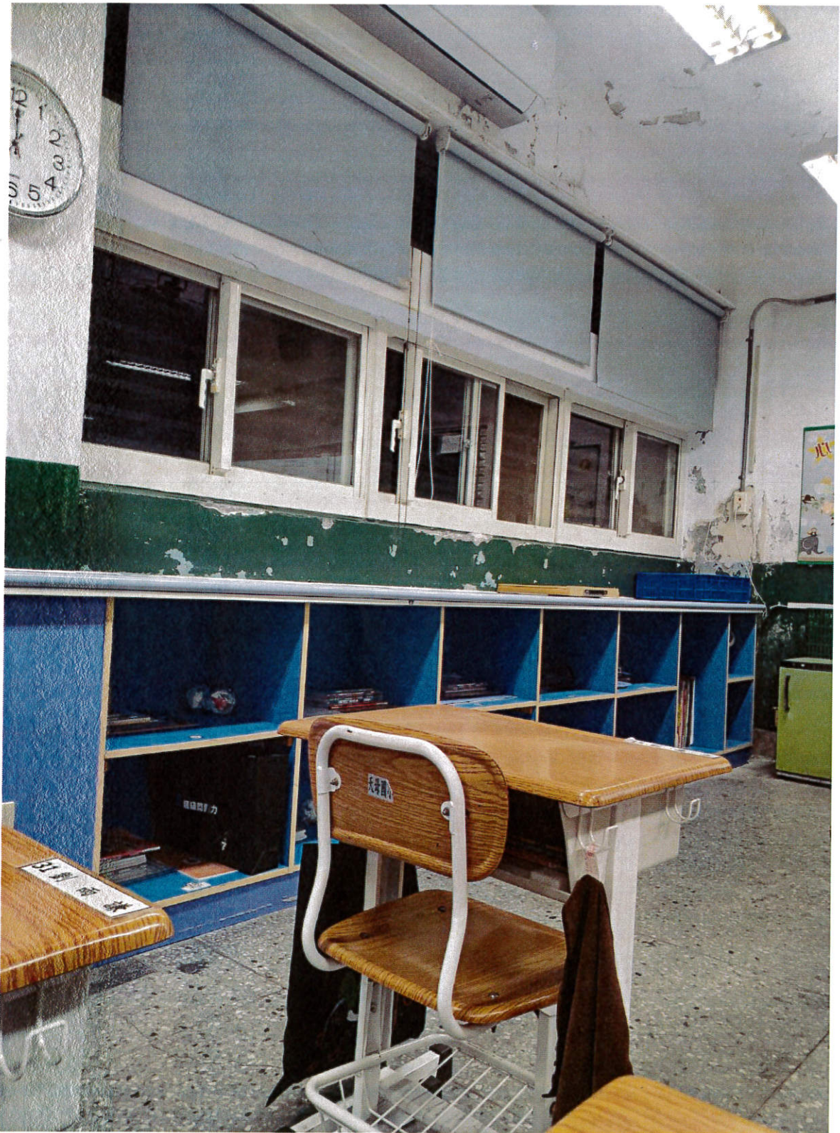
仁愛樓 503 教室滲水產生壁癌，已請廠商估價修繕。
