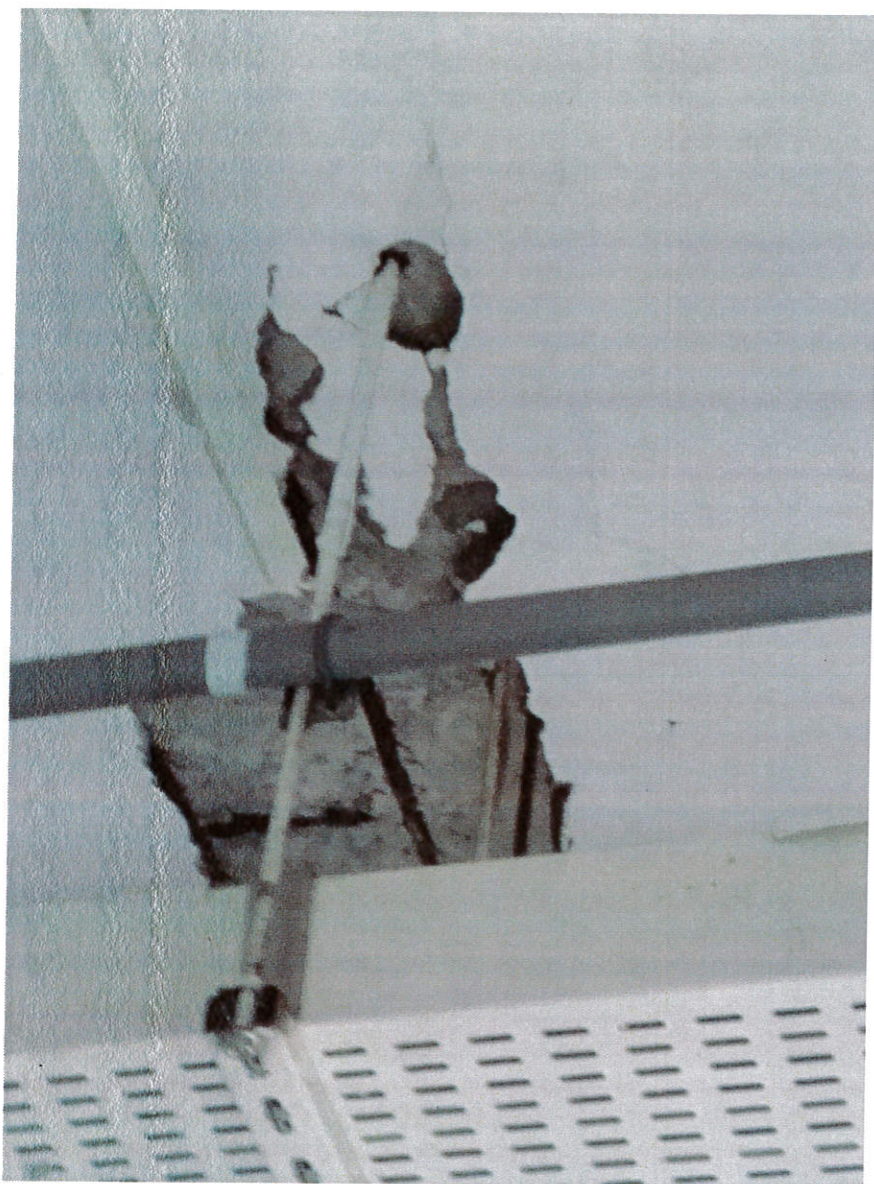
信義樓 402 教室前走廊鋼筋裸露，已請廠商估價修繕。
